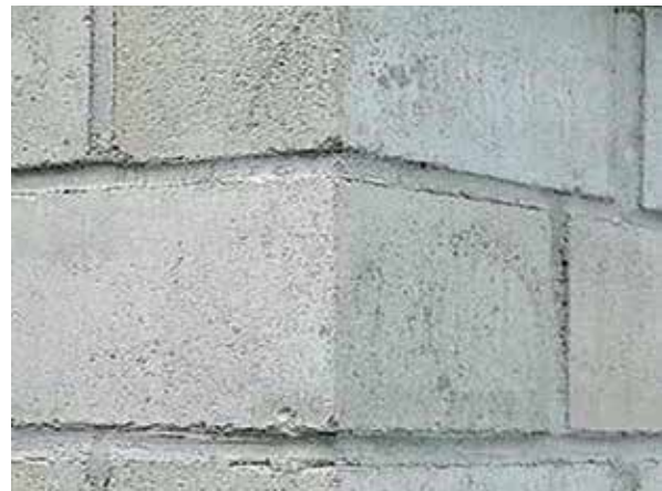
Behandeltes Mauerwerk nach 3 Jahren Freibewitterung.
