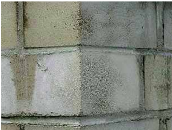
Unbehandeltes Mauerwerk nach 3 Jahren Freibewitterung.
